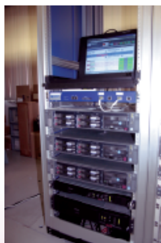
データ放送システム
